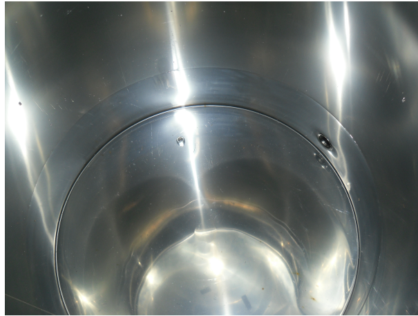
Figura 3.28: Foto della water tank con pareti interne in acciaio inox.
